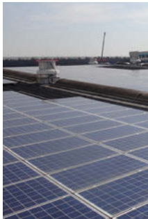
Wuxi plant, China
